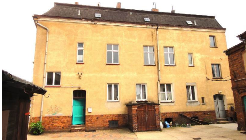
Die Rückseite der Dammstraße 18 vor der Sanierung. Birgit Knabe und Frank Knabe, Eigentümer
